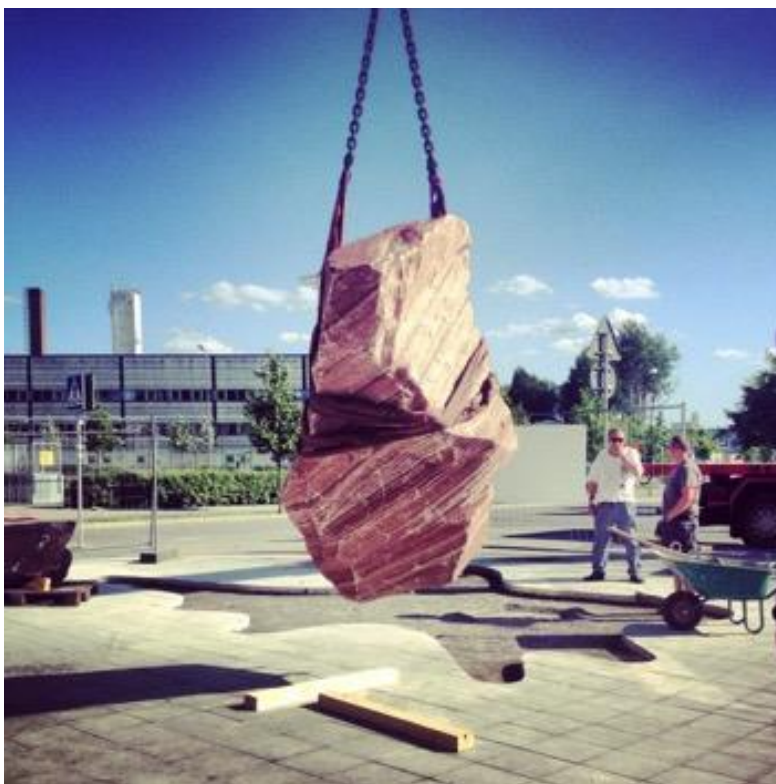
Montering av 15,7 ton älvdalskvartsit, för Stora Ursvik. Lena Ignestam/Carina Zunino, "Drop rock", Beställare Stockholms Sjukhem. Projektledning: AM Public.
